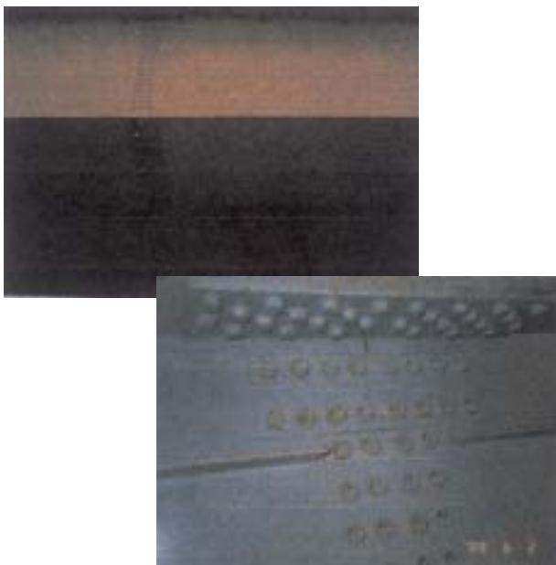
写真1 高力ボルト摩擦接合継手
