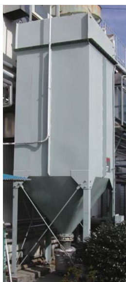
写真5 ろ過集塵装置の外観
