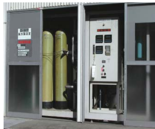
写真4 純水製造装置の外観
