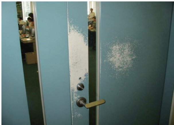
写真1 皮脂軟化による不具合事例 (鉄扉の塗膜剥離)
