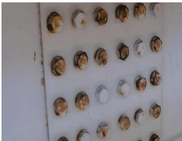
写真3 腐食劣化した添接部
